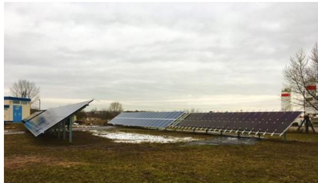
Abbildung: PV-Testfeld in BBG-Friedenshall
